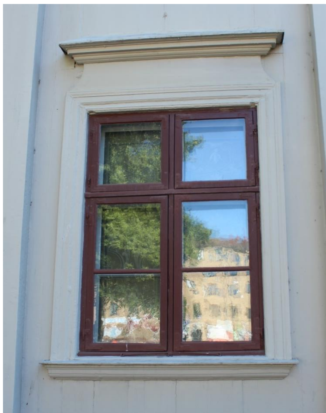
URSPRUNGLIGA FÖNSTER MED FYRA LUFTER OCH SPRÖJS I DE NEDRE LUFTERNA. KRAFTIGT ÖVERSTYCKE.
