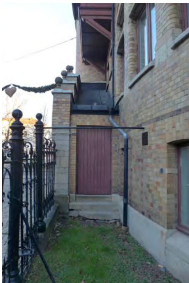
Entré till trapphustornet, idag igensatt och försedd med ett modernt dörrblad som inte är anpassat till husets karaktär.
