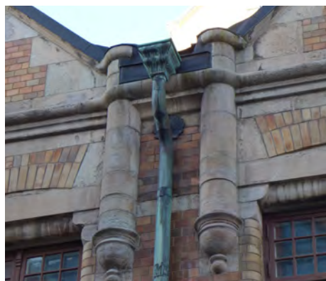
Dekorativa tureller mot öst saknar idag sina krönklot. Notera även ursprungligt stuprör av koppar med profilerad vattkupa.
