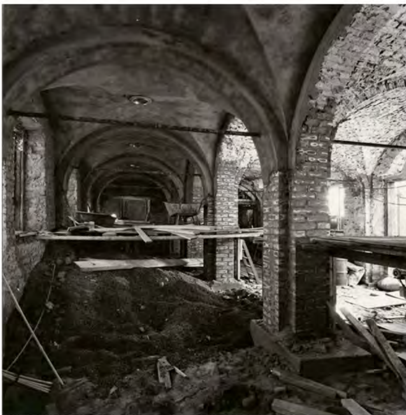
Bilder från 1970-talets omfattande restaurering. Byggnaderna var i tekniskt dåligt skick och åtgärderna var genomgripande med bl a total omputsning, partiell ommurning av såväl fasader som murade valv i smedjan. Samtliga fönster och dörrblad byttes mot nyttillverkade efter förlaga från äldre fotografier. Bilden ovan till höger visar den entré som sedan tidigare hade breddats men nu återställdes. (GSM)
