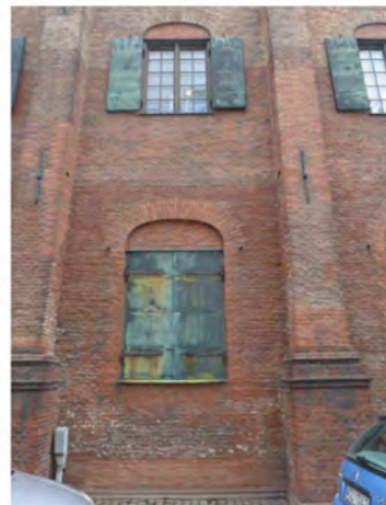
Synliga skarvar i mur mellan Holländskt och svenskt tegel, fasad mot norr.
