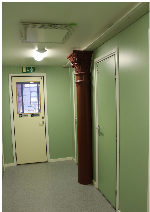
I ENTRESOLPLANET SOM BYGGDES PÅ 1980-TALET FINNS DE URSPRUNGLIGA GJUTJÄRNSPELARNA BEVARADE I KORRIDORERNA MELLAN OMKLÄDNINGSRUMMEN.
