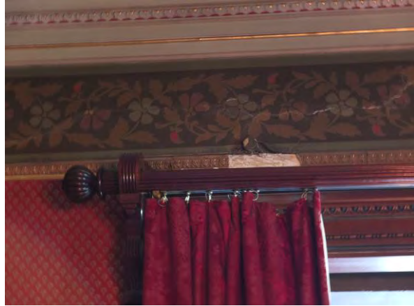
Bemålad fris och förgylld stucklist med skada.
