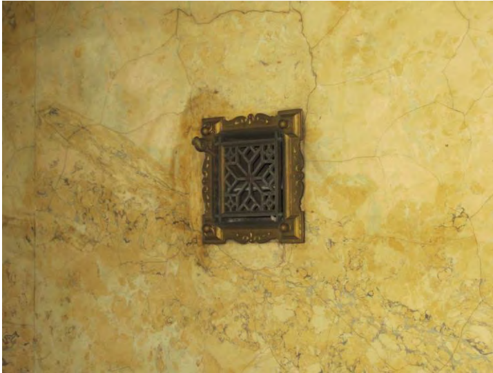
Ventilgaller på marmorerad vägg med gjutjärnsdekor.
