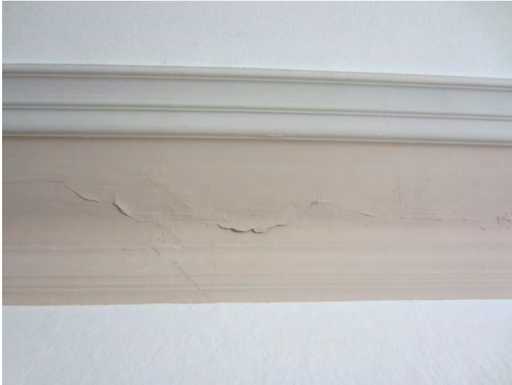
Flagnor i taklistens färg.
