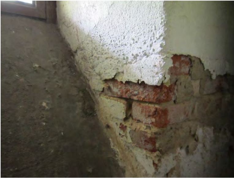
Putsskada på vägg vid fönsternisch.
