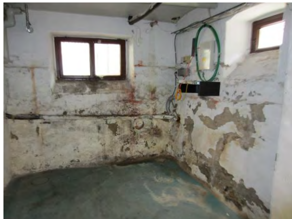
Rum 105 med fuktskador på väggar.
