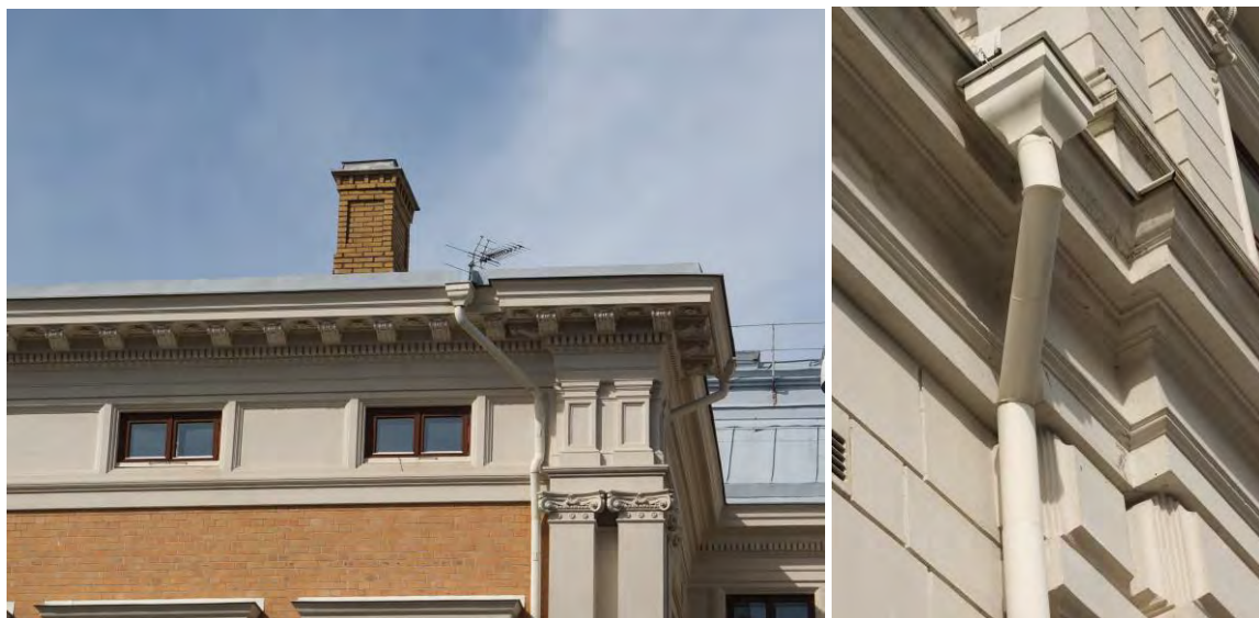
Vattenavrinningsystem med äldre kupor och målade skarpvinkelrör av koppar.
