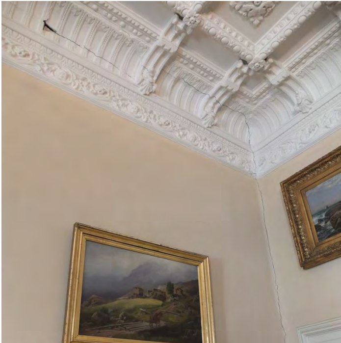
Tak med allvarliga sprickor pga. sättningskador i huset.
