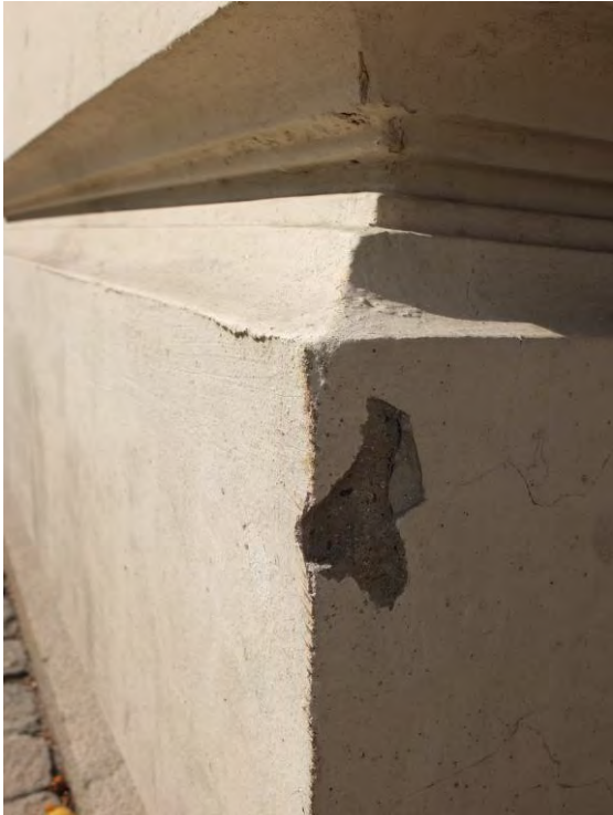
Putsskada på sockel mot Storgatan.
