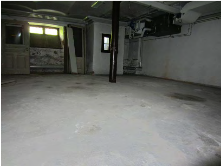
Golv som buktar i rum 112 med sättningsskador.
