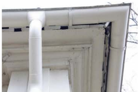
Hängränna och stupränna i plåt, målad i fasadens kulör.
