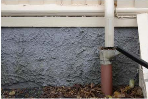
Spritputsad sockel avfärgad med grått.
