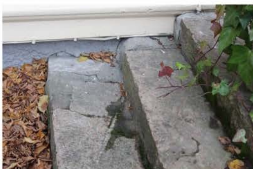
Sprucken sten, nedersta stenen med bakfall.
