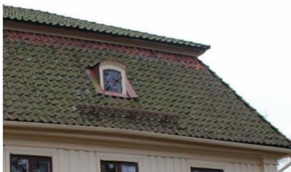
Taket har delvis kraftig påväxt. Notera skillnaden i den skyddade delen mot det övre takfallet.
