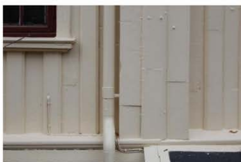
Panelen är äldre och delvis utbytt i utsatta lägen.
