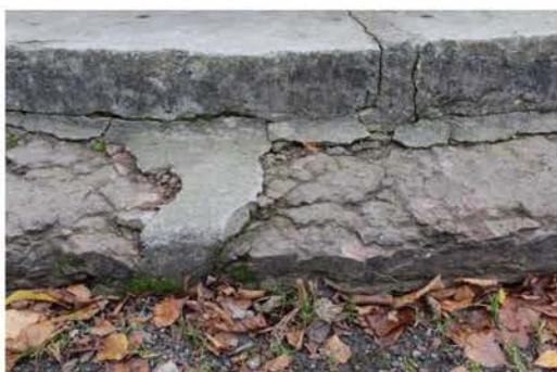
Kraftigt vittrad sten och fogsläpp vid huvudentré.
