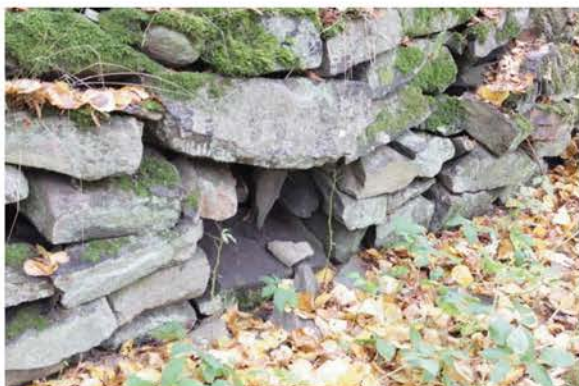
Mur som håller på att rasa samman.
