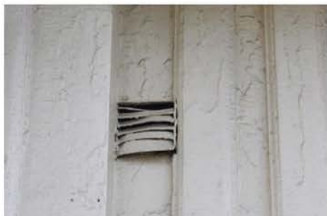
Skadat ventilationsgaller i plåt.
