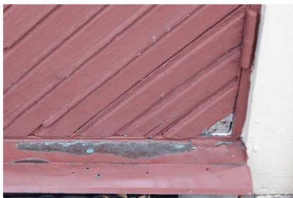
Skador i träpanel, färgsläpp på kopparplåt.
