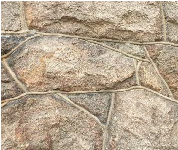
GRANITSOCKELN PÅ ENTRÉBYGGNADENS HUVUDFASAD HAR FÖRSETTS MED ÅSAD FOG.
