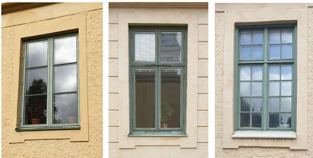
EXEMPEL PÅ SENARE FÖNSTER. FRÅN VÄNSTER: SPRÖJSAT TVÅLUFTSFÖNSTER (BYGGNAD 1) KORSPPOSTFÖNSTER (BYGGNAD 2) OCH SMÅSPRÖJSAT KORSPPOSTFÖNSTER (BYGGNAD 8)
