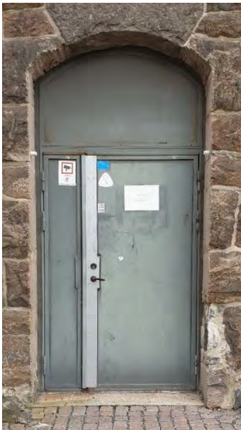
SENARE DÖRRÖPPNING VID URSPRUNGLIGT CELLFÖNSTER I SOCKELVÅNINGEN. STÅLDÖRR SAMT IGENSATT ÖVERLJUS BYGGNAD 4.
