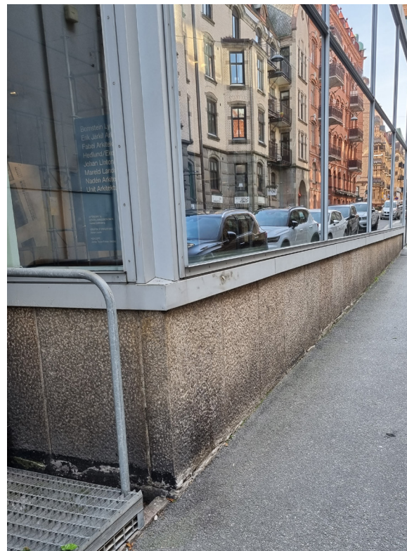
Tillbyggnaden står på en sockel av pikhuggen granit lika huvudbyggnaden, vilket härrör från tillbyggnaden 1937. I övrigt präglas byggnaden av förändringar på 1960-talet.
