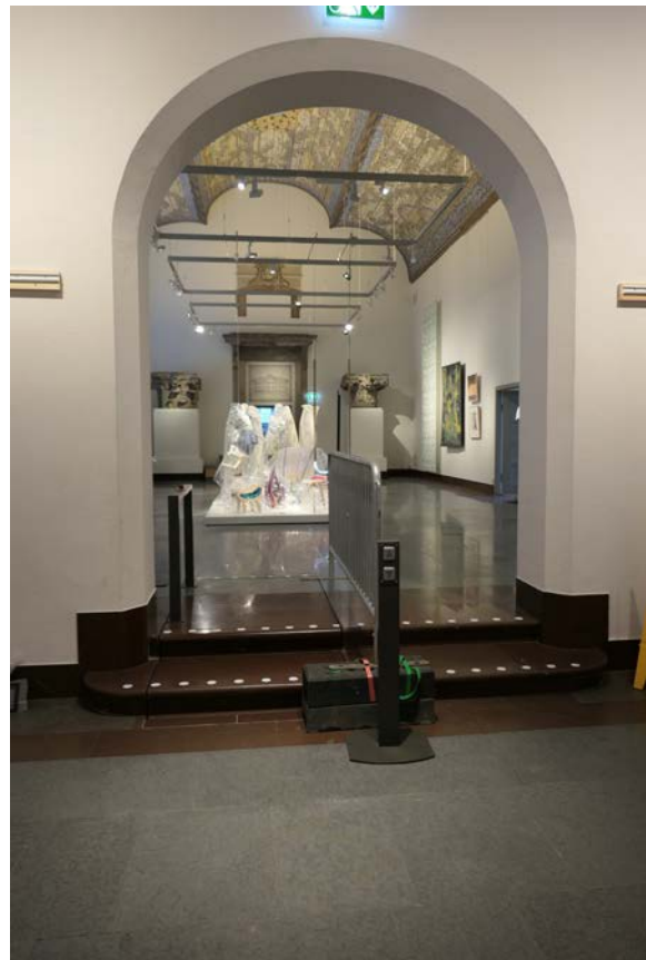
År 2019 installerades en trapphiss mellan vestibulen och arkitekturhallen.
