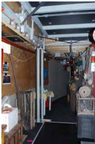
Rum B 108, Orkesterdike. Ovan putsskada i passage.
