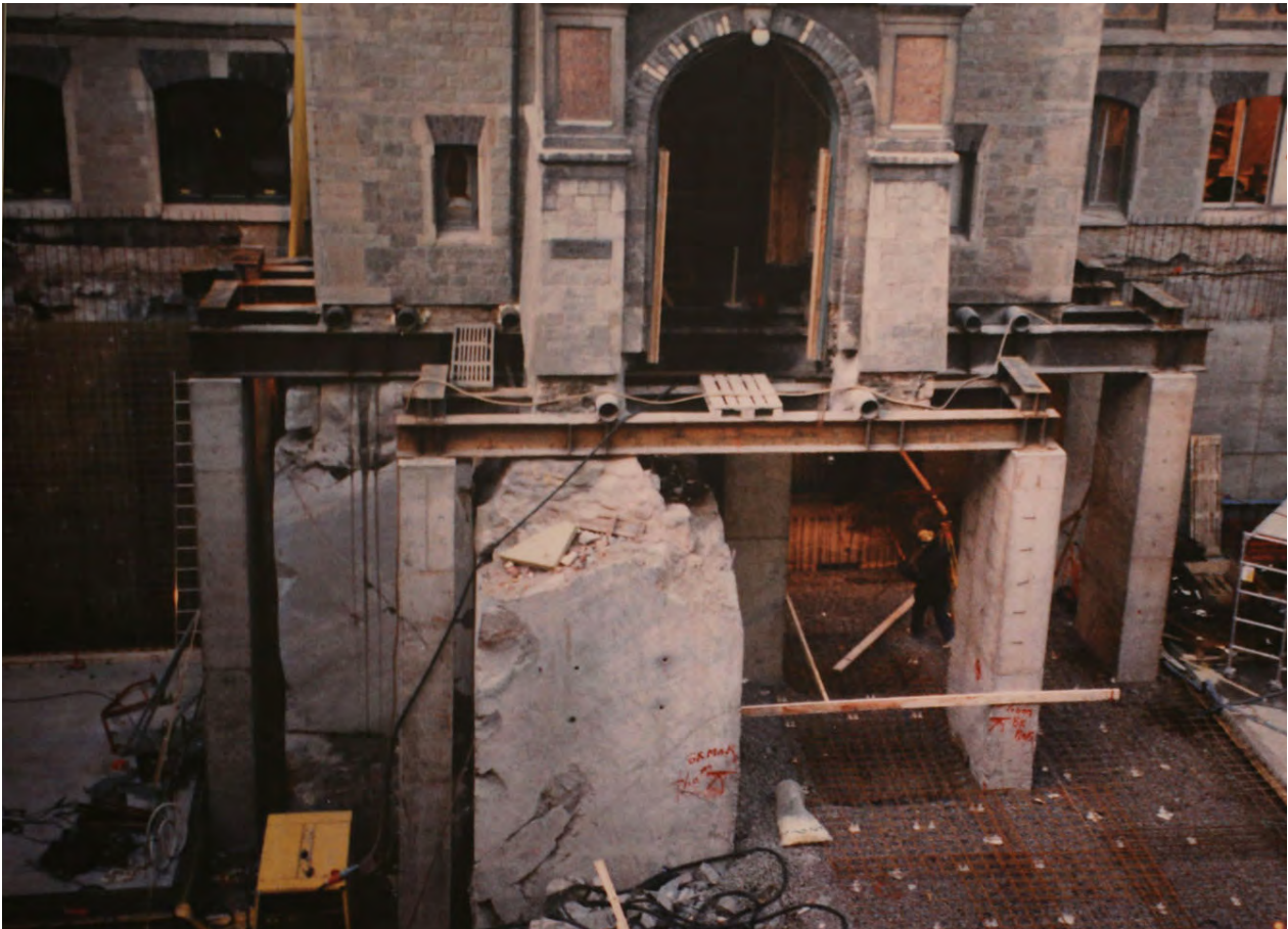
Under fyra år i början av 1990-talet genomfördes en omfattande om- och tillbyggnad av Ostindiska huset. Här grävs gården upp för att ytan ska omvandlas till entré och hörsal. Bild ur Göteborgs stadsmuseums arkiv.
